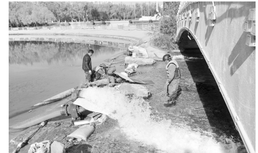
近日，施工人员对东湖生态旅游二湖进行抽水，开始对湖体周围松动的砖块进行维修加固，确保湖体安全。 融媒体中心记者 高深 摄
